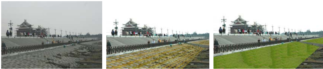
圖 4- 17 將原有堤腳的部分種植 1 公尺以下的矮灌叢，首先於堤腳設置木格框，再放置客土袋植生，作為阻絕設施並美化海岸景觀。
