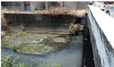
舊鹿港溪河道淤積
