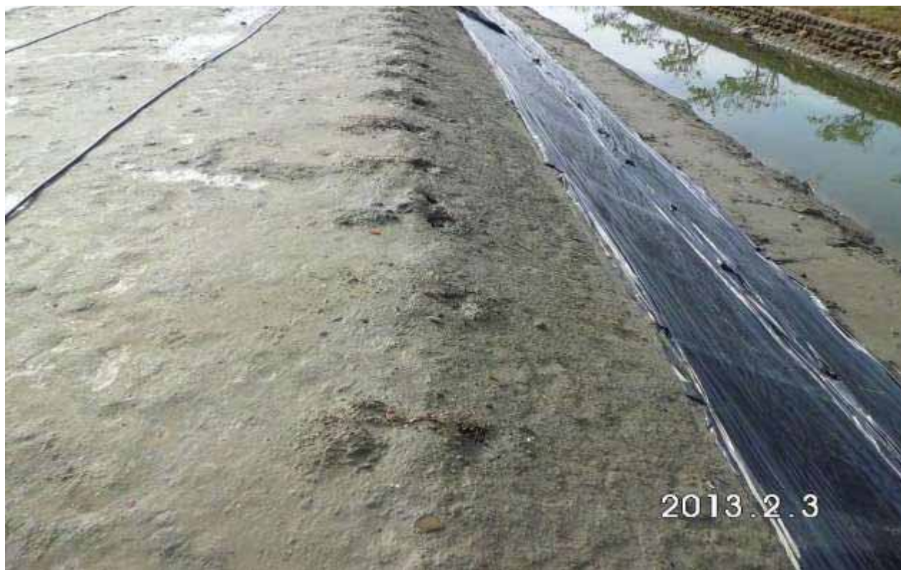
土堤緊鄰潮溝側（北側）邊坡覆蓋塑膠布，植以馬鞍藤與南美蟛蜞菊皆死亡
