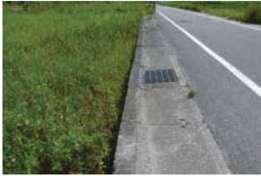
照片 21 道路箱式涵管阻斷農田排水
