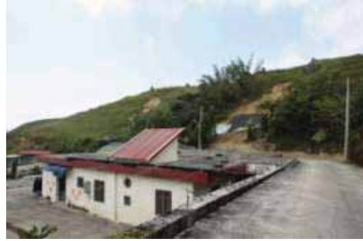
照片 32 民宿後方大面積的崩塌
