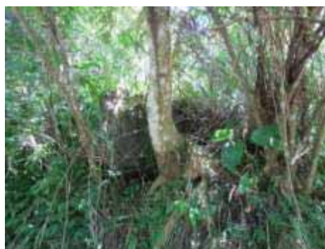
照片 28 東側坡面早期崩落滾石
