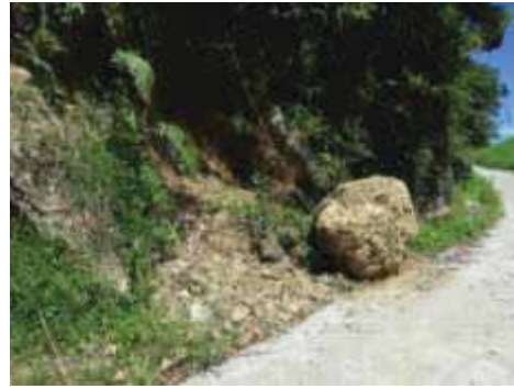
照片 30 濕地西側小徑旁邊坡崩塌
