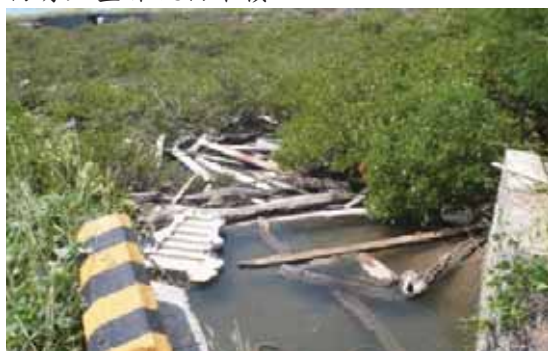
照片 106. 第 7-2 樣區水道出入口仍堆積大量之木板及漂流木等
