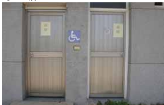
照片 118. 社區廁所故障無法使用相當不便
