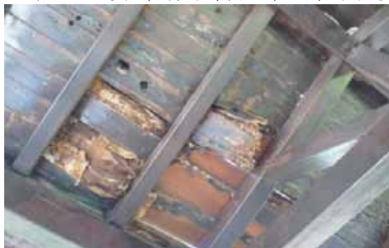
照片 116. 2012 年 8 月觀察涼亭屋頂有腐朽現象
